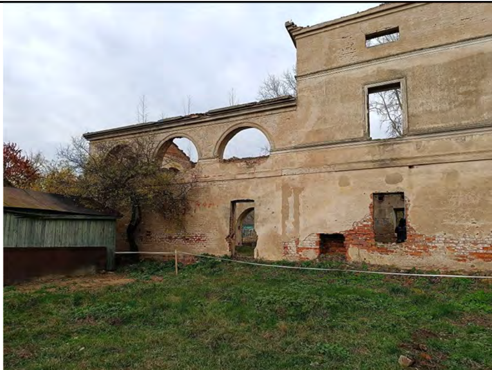
Фото 59 Фрагмент общего вида пристройки здания (увлажнение, размораживание кладки наружной стены пристройки)
