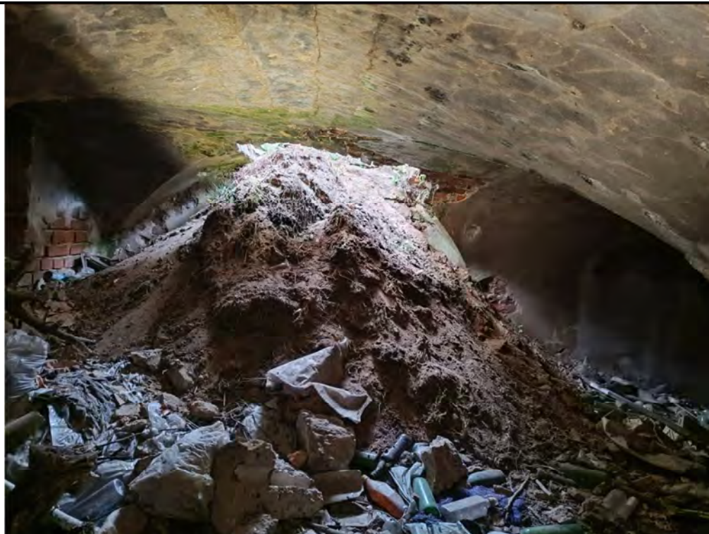
Фото 75 Фрагмент люка спуска в подвал (засорение спуска в подвал грунтом и мусором)
