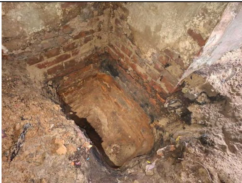
Фото 60 Фрагмент фундамента под наружными стенами пристройки здания на участке откопки шурфа (шурф №2)
