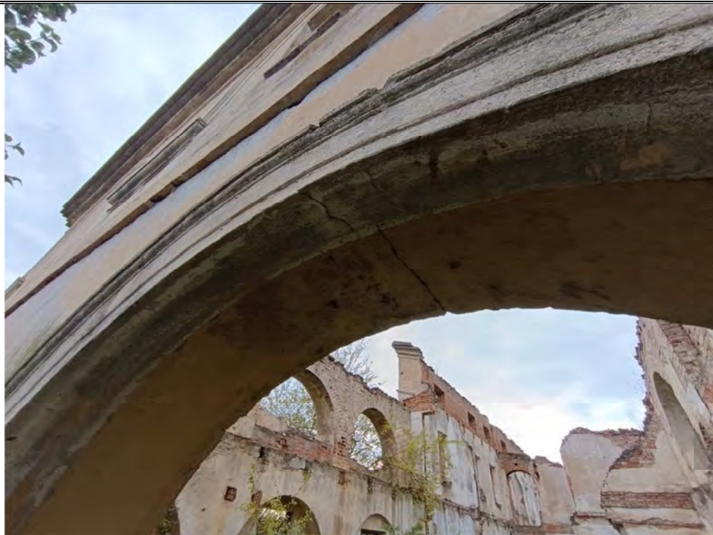
Фото 114 Фрагмент перемычки над арочным проемом пристройки в осях «9/А-Б» (сквозная нормальная трещина по перемычке)
