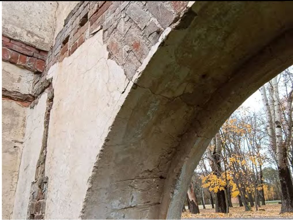
Фото 113 Фрагмент перемычки над арочным проемом пристройки в осях «8-9/Б» (сквозная нормальная трещина по перемычке)
