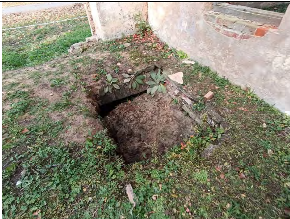
Фото 76 Фрагмент люка спуска в подвал (засорение спуска наносами грунта; произрастание травы по верхней поверхности перекрытия над подвалом)
