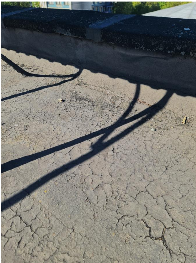
Фото 35. Износ, растрескивание кровельного покрытия
