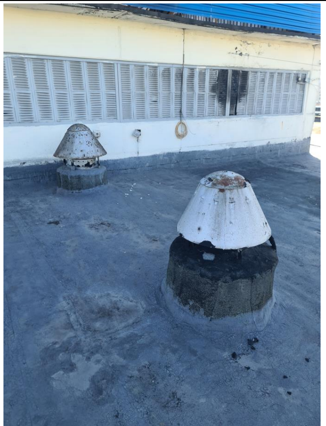
Фото 54. Коррозия металлических колпаков вытяжной вентиляции
