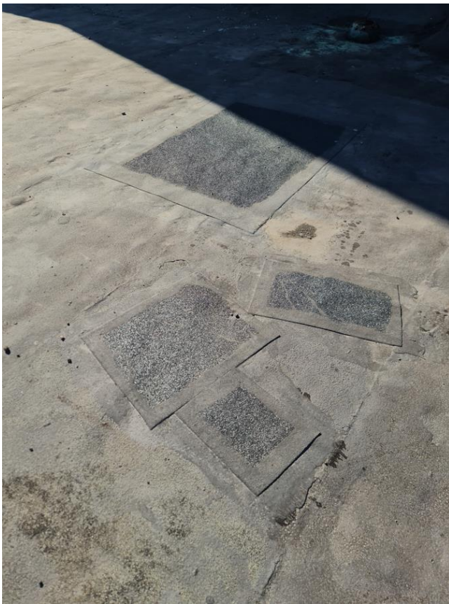
Фото 25. Некачественно выполнен ремонт кровельного покрытия
