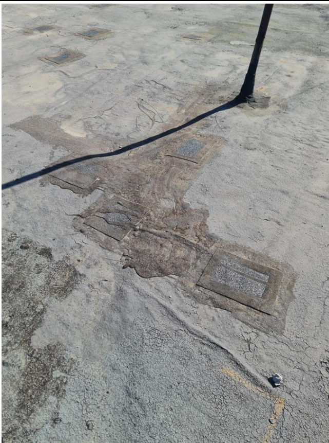
Фото 41. Некачественно выполнен ремонт кровельного покрытия
