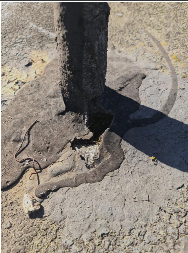
Фото 37. Нарушение целостности, износ кровельного покрытия
