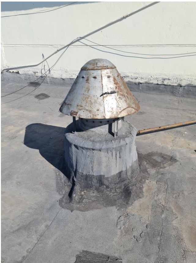
Фото 55. Коррозия металлического колпака вытяжной вентиляции
