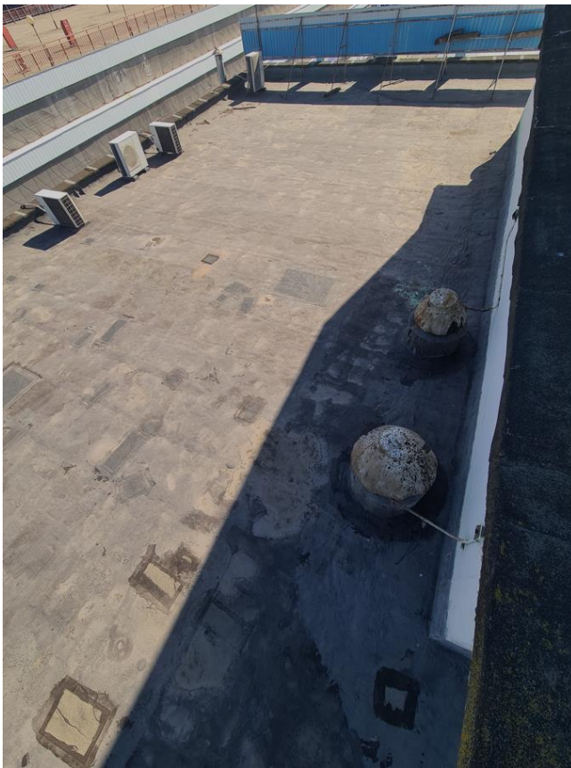
Фото 7. Износ, следы застаивания атмосферных осадков, бугристости рулонного ковра в осях Г-В/2-4
