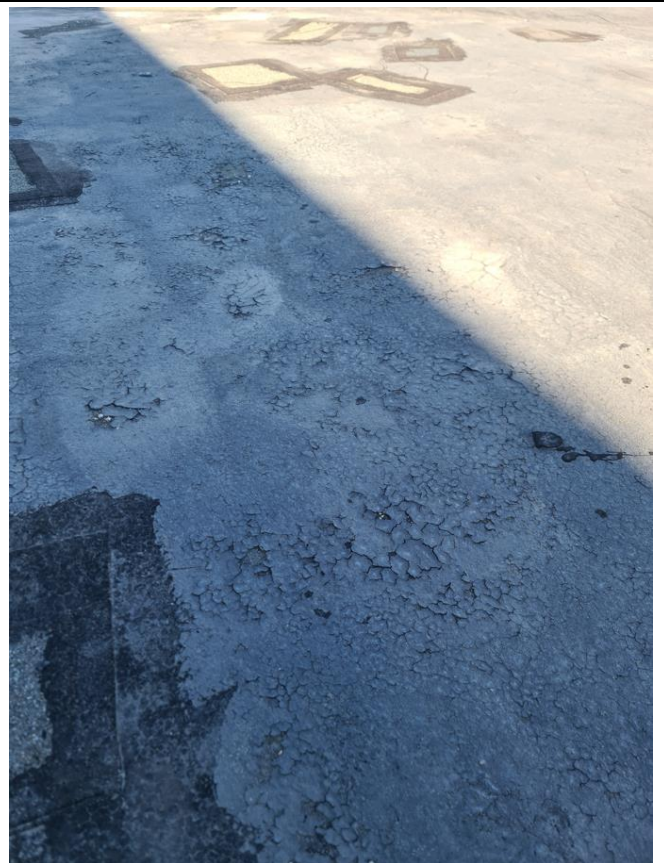
Фото 30. Износ, растрескивание кровельного покрытия
