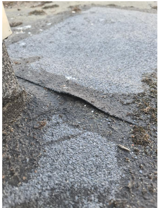
Фото 83. Некачественно выполнен ремонт кровельного покрытия
