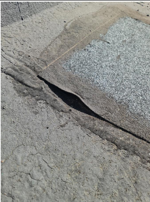
Фото 45. Некачественно выполнен ремонт кровельного покрытия
