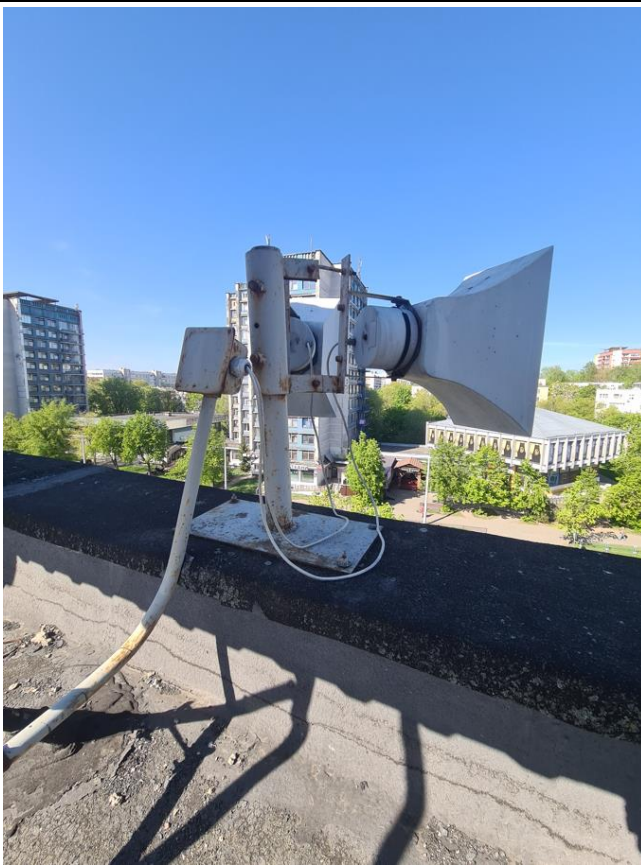
Фото 69. Общий вид системы оповещения населения
