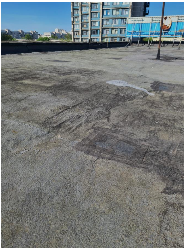
Фото 47. Износ, бугристости кровельного покрытия
