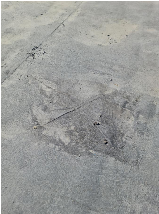
Фото 19. Нарушение целостности, износ кровельного покрытия
