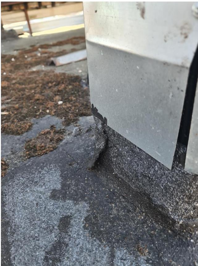
Фото 82. Отслоение рулонного ковра в узле примыкания кровли к вентиляционной трубе
