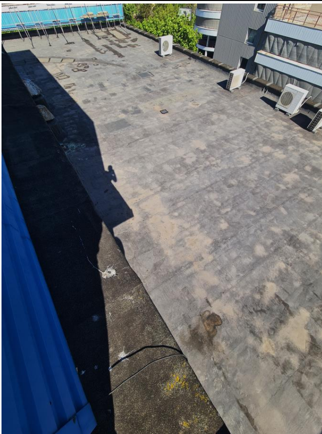
Фото 5. Следы застаивания атмосферных осадков, бугристости рулонного ковра в осях В-Г/3-4
