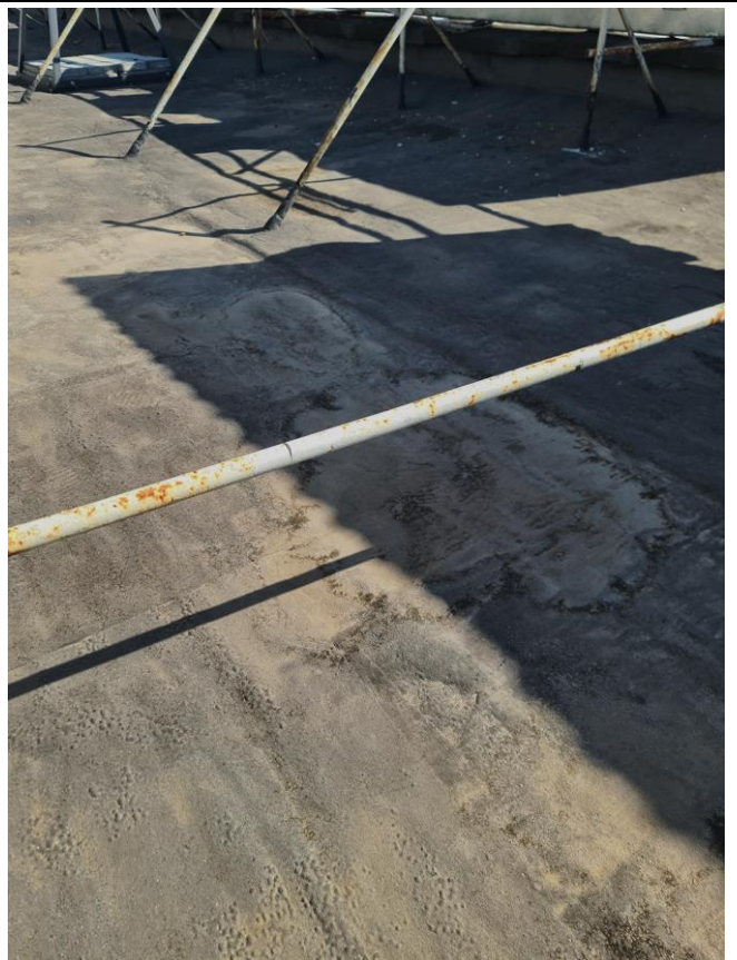
Фото 50. Износ, растрескивание, следы застывания атмосферных осадков на поверхности кровельного покрытия
