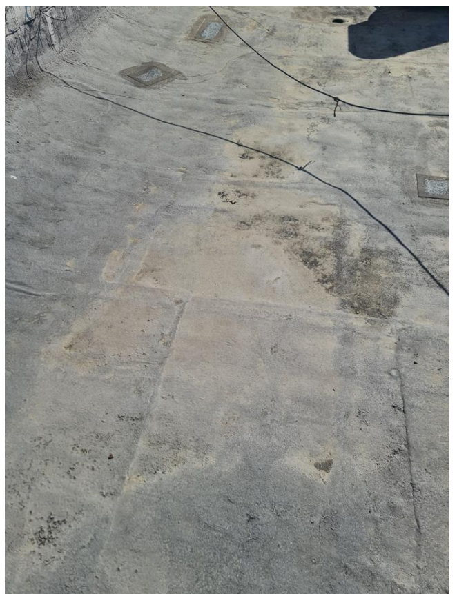
Фото 44. Износ, следы застаивания атмосферных осадков на поверхности кровельного покрытия
