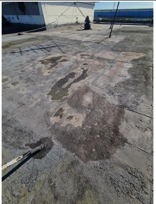
Фото 38. Износ, растрескивание, следы застывания атмосферных осадков на поверхности кровельного покрытия
