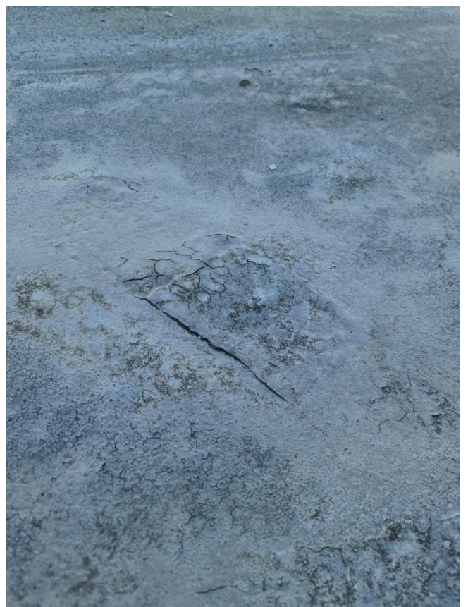
Фото 32. Нарушение целостности, износ кровельного покрытия
