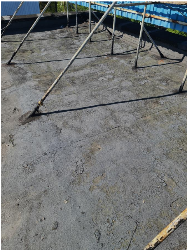
Фото 39. Износ, растрескивание кровельного покрытия
