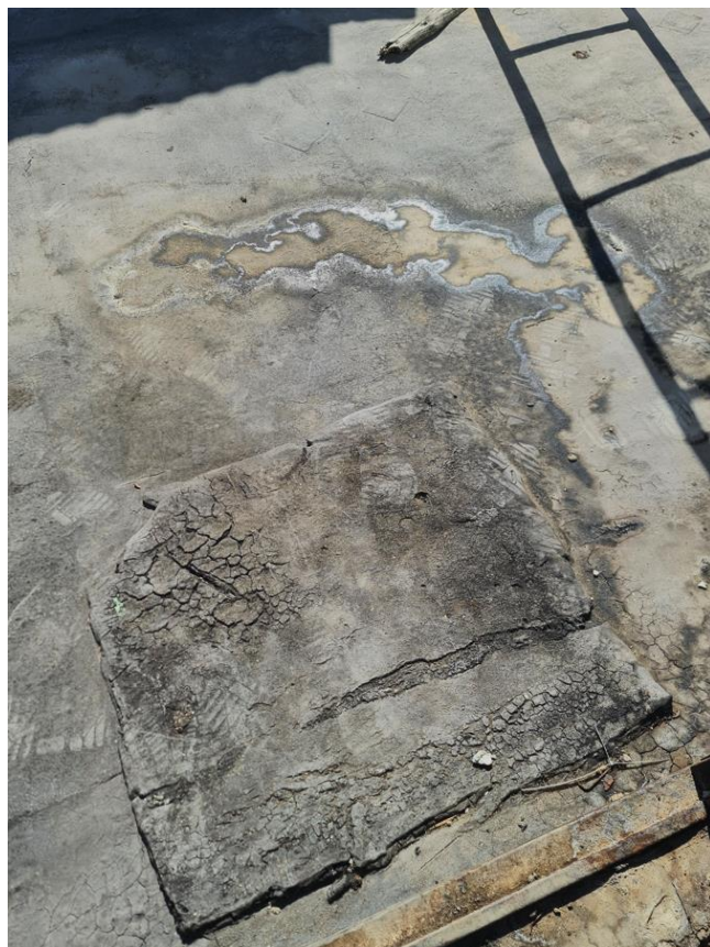
Фото 12. Износ, следы застывания атмосферных осадков на поверхности кровельного покрытия
