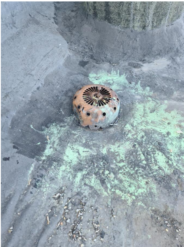
Фото 51. Коррозия металлического листоуловителя
