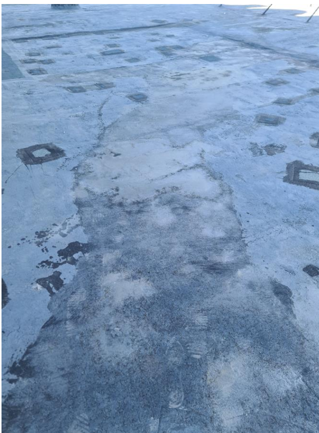
Фото 31. Износ, следы застаивания атмосферных осадков на поверхности кровельного покрытия
