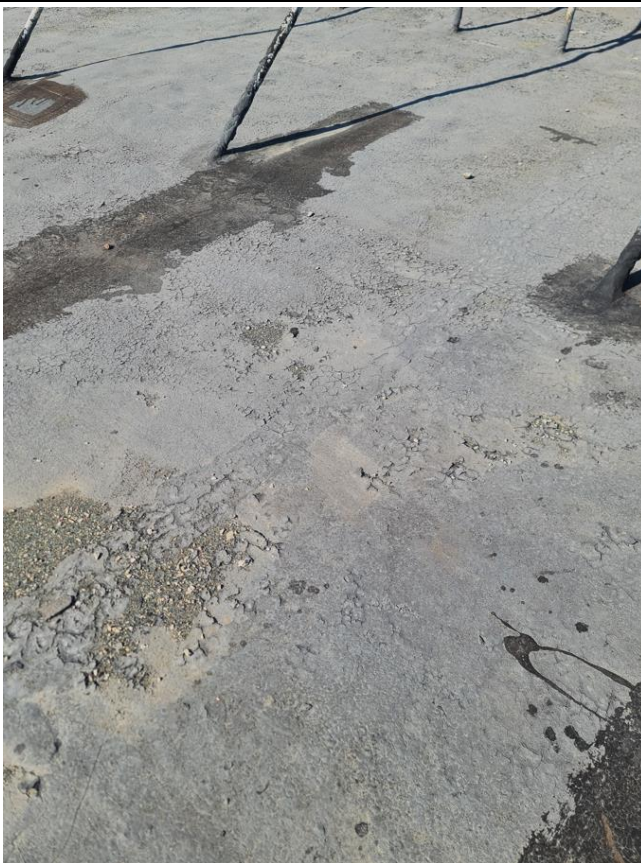
Фото 33. Износ, растрескивание, следы застывания атмосферных осадков на поверхности кровельного покрытия
