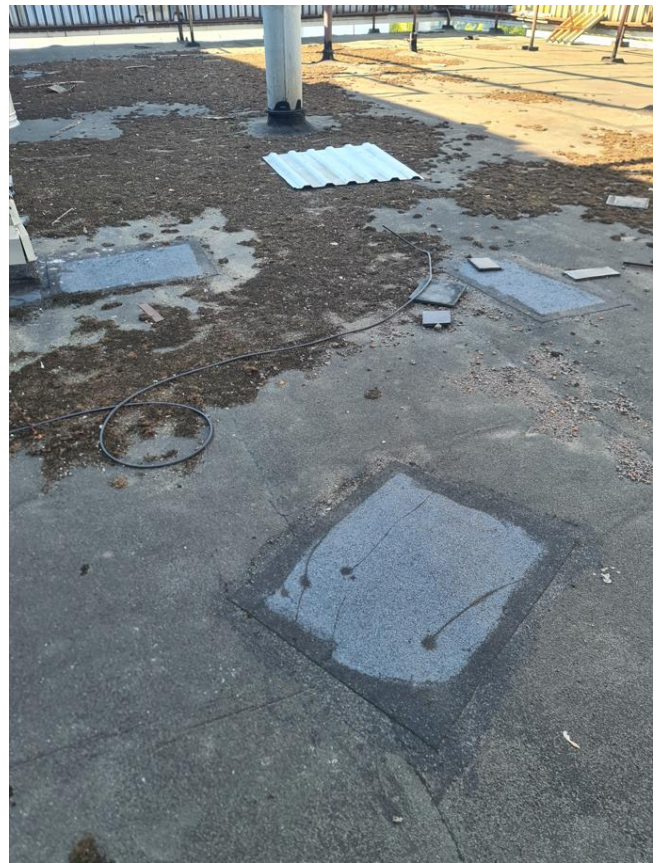
Фото 81. Замшелости кровельного покрытия осях Б-В/2-3
