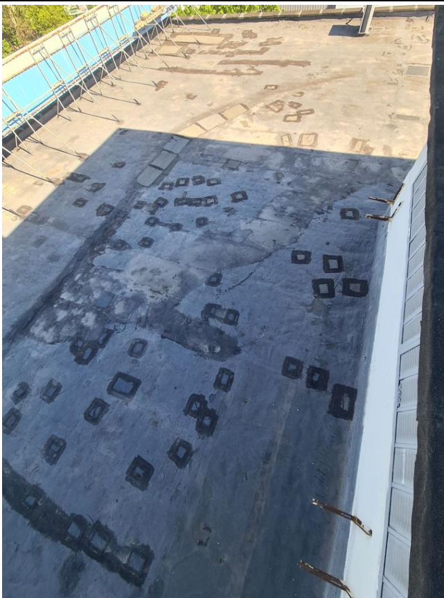
Фото 9. Некачественно выполнен ремонт кровельного покрытия, следы застывания атмосферных осадков, бугристости рулонного ковра в осях Г-В/2-4
