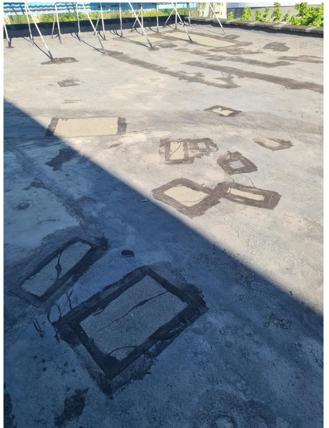
Фото 28. Некачественно выполнен ремонт кровельного покрытия
