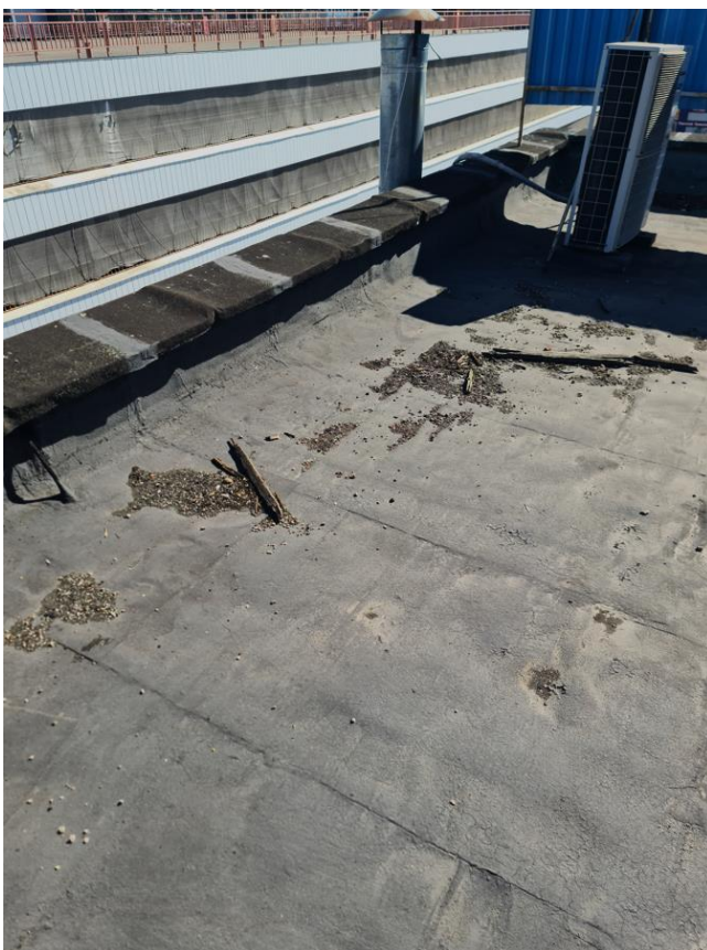
Фото 15. Следы застаивания атмосферных осадков, скопление биологического мусора на поверхности кровельного покрытия
