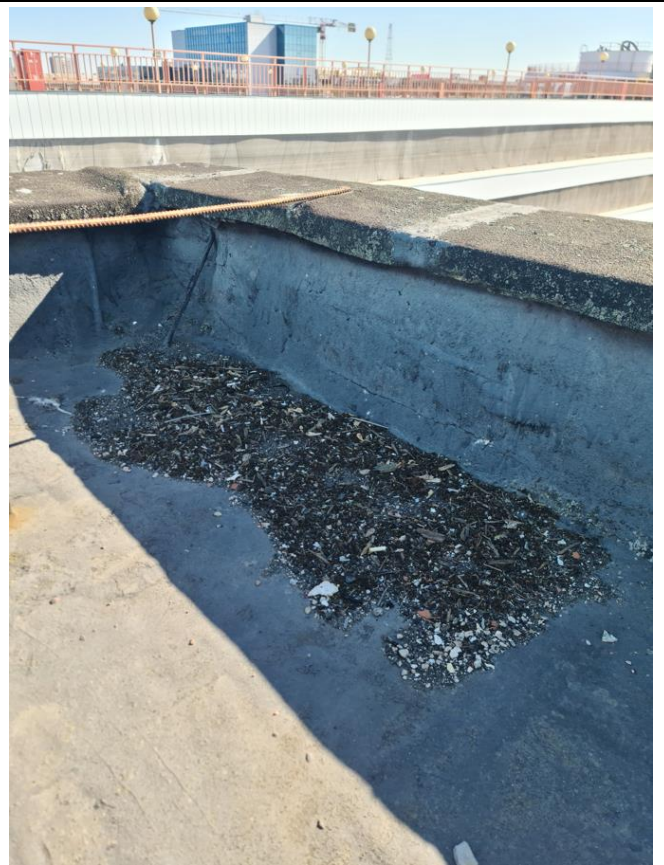
Фото 18. Скопление биологического мусора на поверхности кровли
