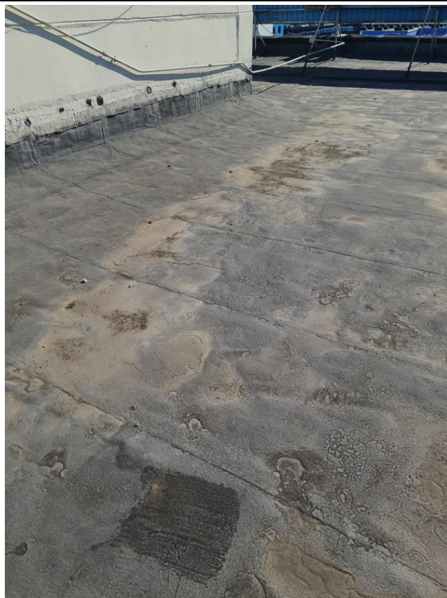
Фото 46. Износ, следы застывания атмосферных осадков на поверхности кровельного покрытия
