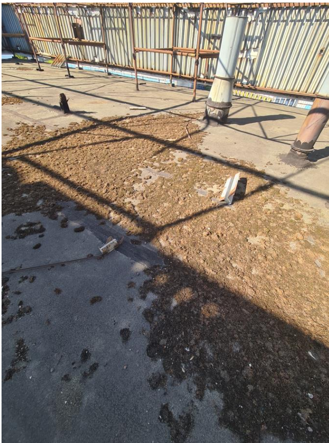
Фото 80. Замшелости кровельного покрытия в осях Б-В/2-3
