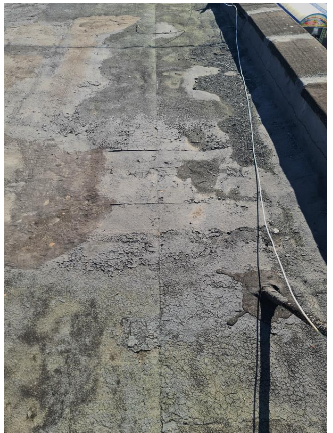
Фото 40. Износ, растрескивание кровельного покрытия
