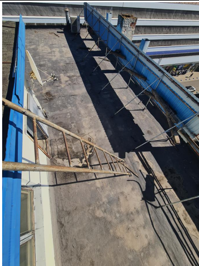
Фото 10. Следы застывания атмосферных осадков, бугристости рулонного ковра в осях В-А/3-4
