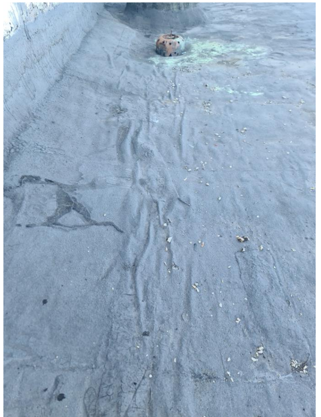
Фото 24. Бугристости кровельного покрытия
