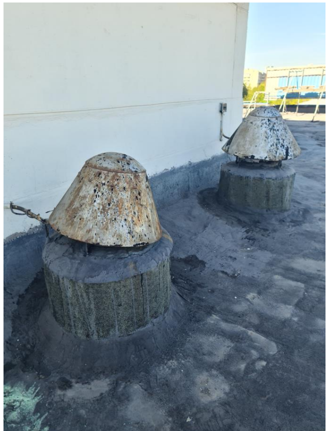
Фото 56. Коррозия металлических колпаков вытяжной вентиляции
