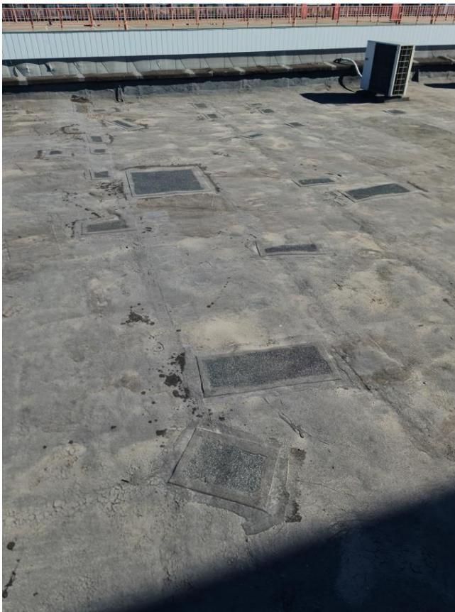
Фото 27. Износ, следы застывания атмосферных осадков на поверхности кровельного покрытия
