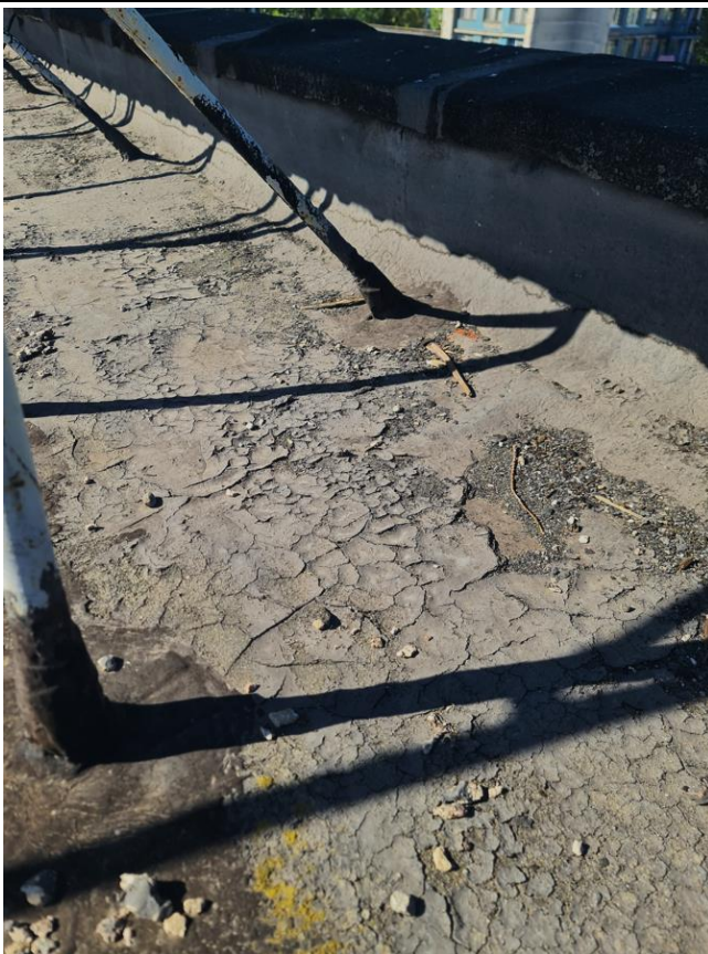
Фото 13. Износ, растрескивание кровельного покрытия
