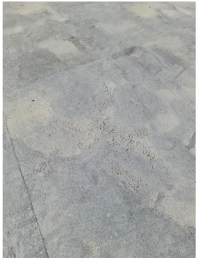
Фото 20. Износ, растрескивание кровельного покрытия
