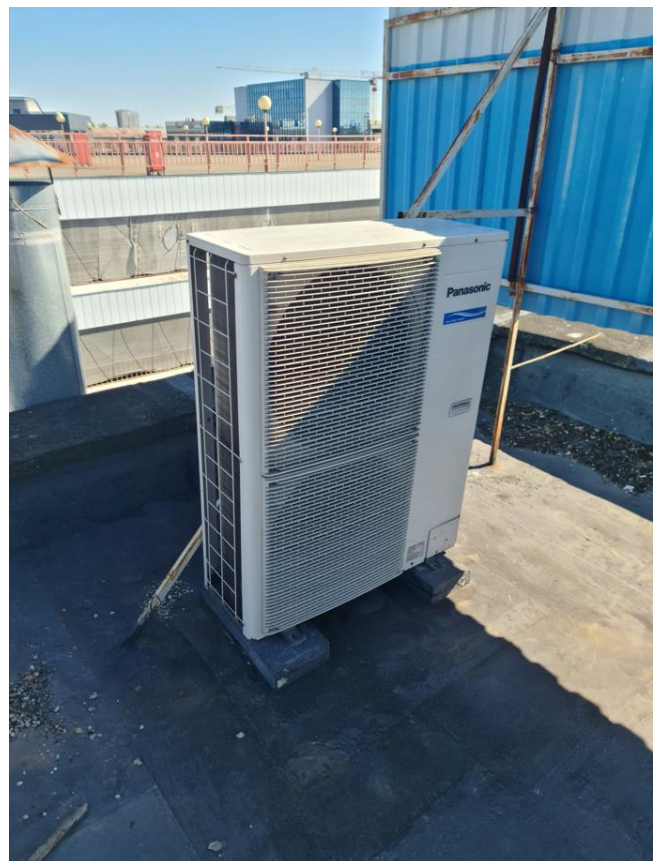
Фото 72. Общий вид оборудования на поверхности кровли в осях А/4
