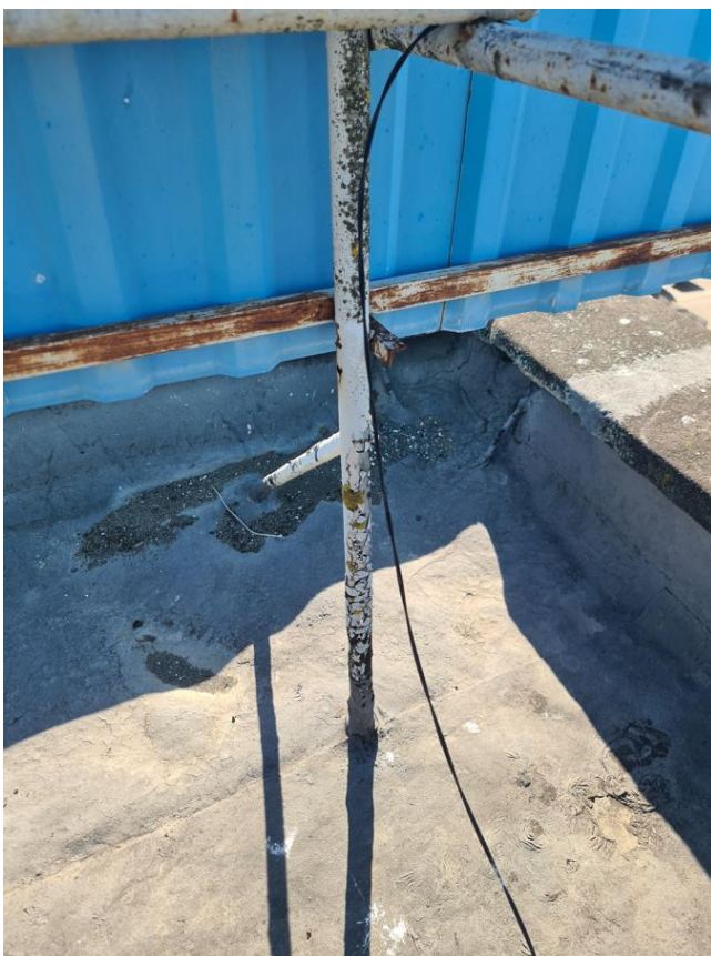
Фото 67. Разрушение окрасочного слоя, коррозия металлического каркаса ограждающе-декоративных конструкций
