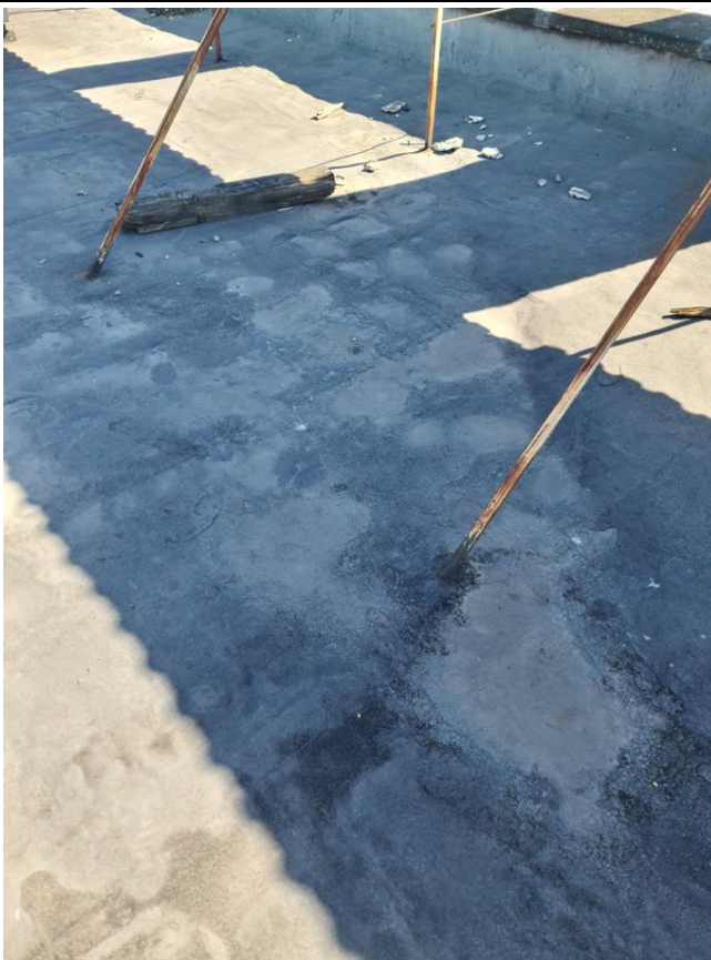
Фото 17. Износ, следы застаивания атмосферных осадков на поверхности кровельного покрытия
