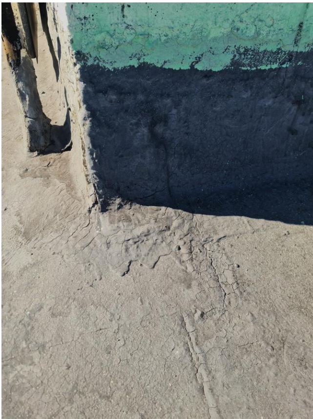
Фото 23. Износ, следы застаивания атмосферных осадков на поверхности кровельного покрытия
