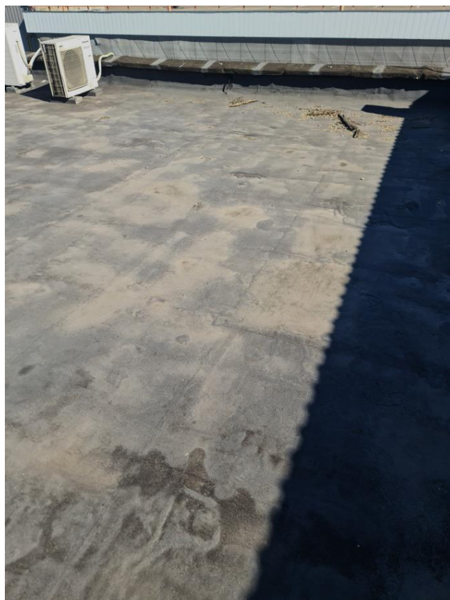
Фото 16. Износ, следы застаивания атмосферных осадков на поверхности кровельного покрытия
