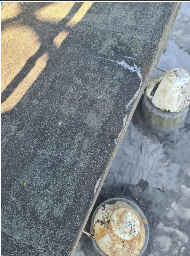
Фото 76. Износ, нарушение целостности кровельного покрытия
