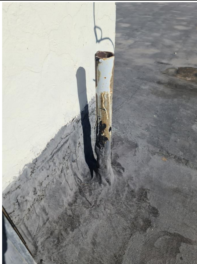
Фото 14. Износ кровельного покрытия
