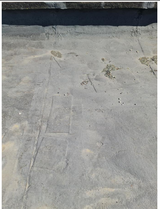
Фото 22. Износ, следы застаивания атмосферных осадков на поверхности кровельного покрытия
