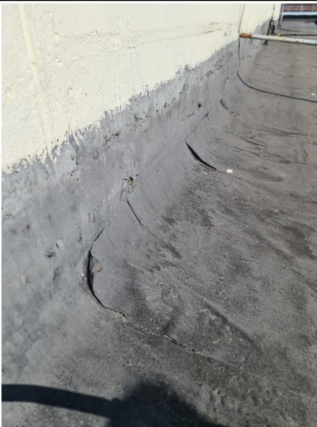
Фото 49. Отслоение рулонного ковра в узле примыкания кровли к стене надстройки
