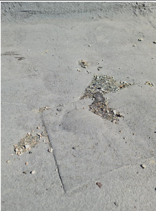
Фото 21. Некачественно выполнен ремонт кровельного покрытия
