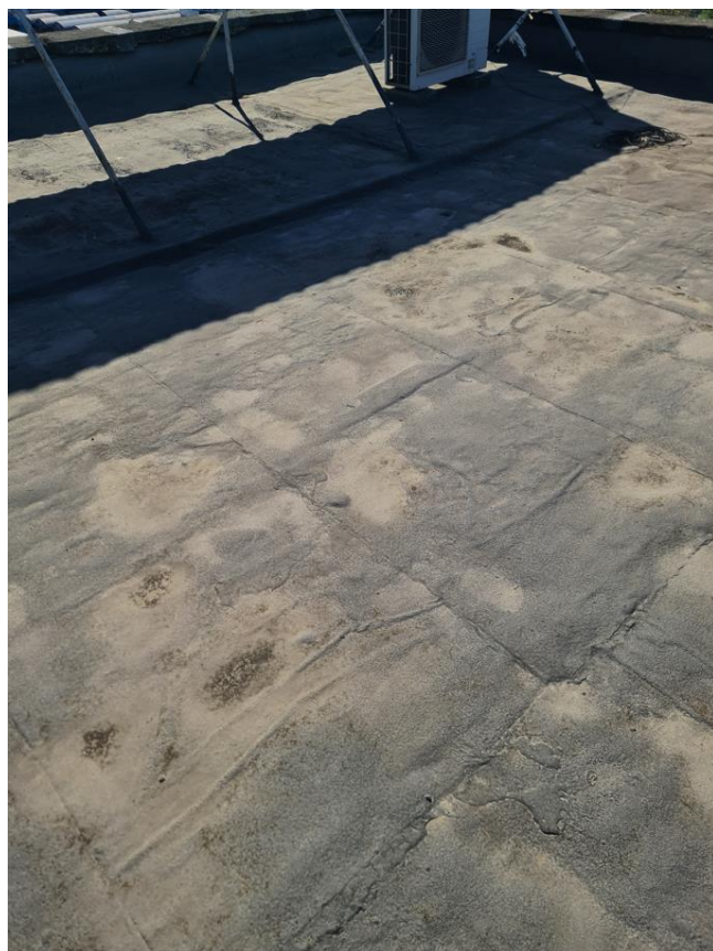
Фото 48. Износ, следы застывания атмосферных осадков на поверхности кровельного покрытия
