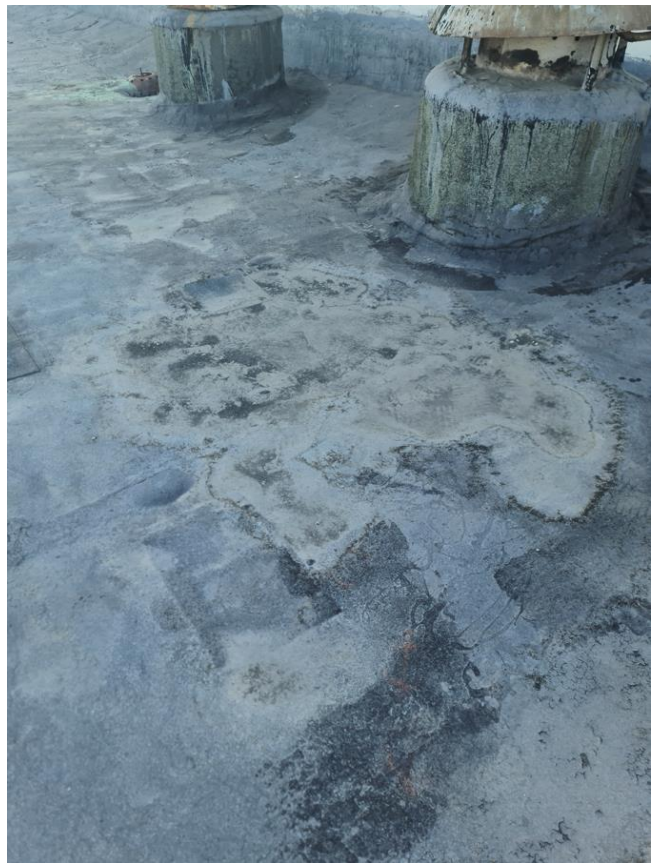
Фото 26. Износ, следы застывания атмосферных осадков на поверхности кровельного покрытия
