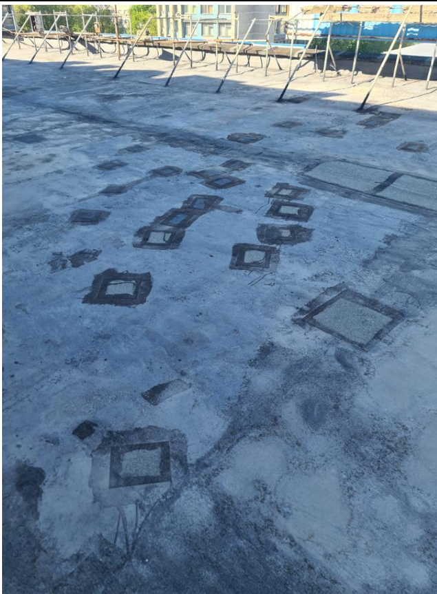
Фото 29. Некачественно выполнен ремонт кровельного покрытия
