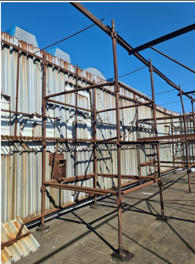
Фото 84. Разрушение окрасочного слоя, коррозия металлического каркаса и профилированного листа ограждающе-декоративных конструкций кровли
