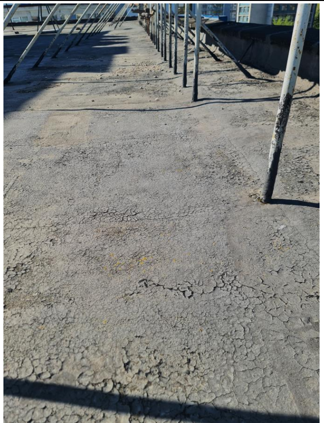
Фото 34. Износ, растрескивание кровельного покрытия
