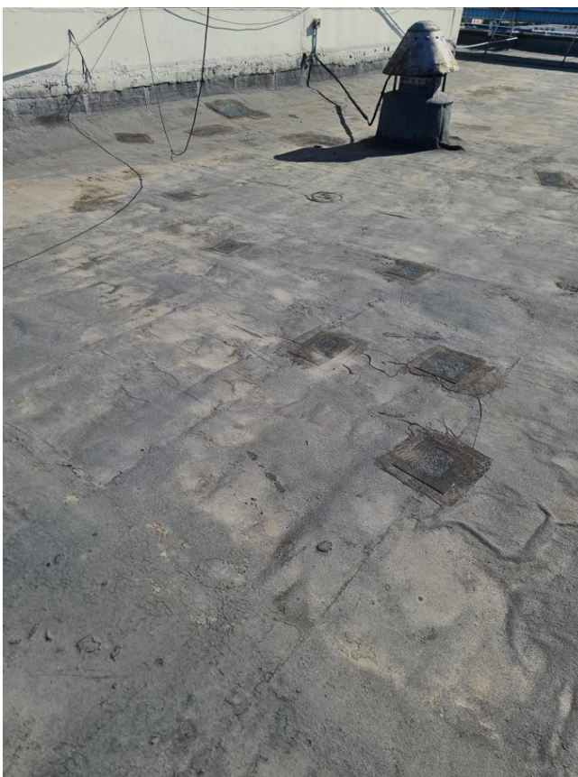
Фото 43. Износ, следы застаивания атмосферных осадков на поверхности кровельного покрытия
