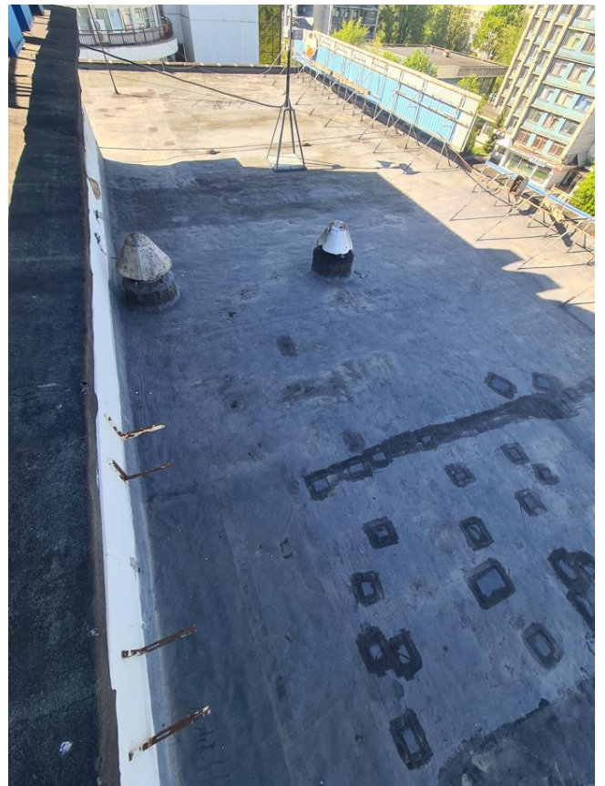
Фото 8. Износ, следы застаивания атмосферных осадков, бугристости рулонного ковра в осях В-Г/3-1
