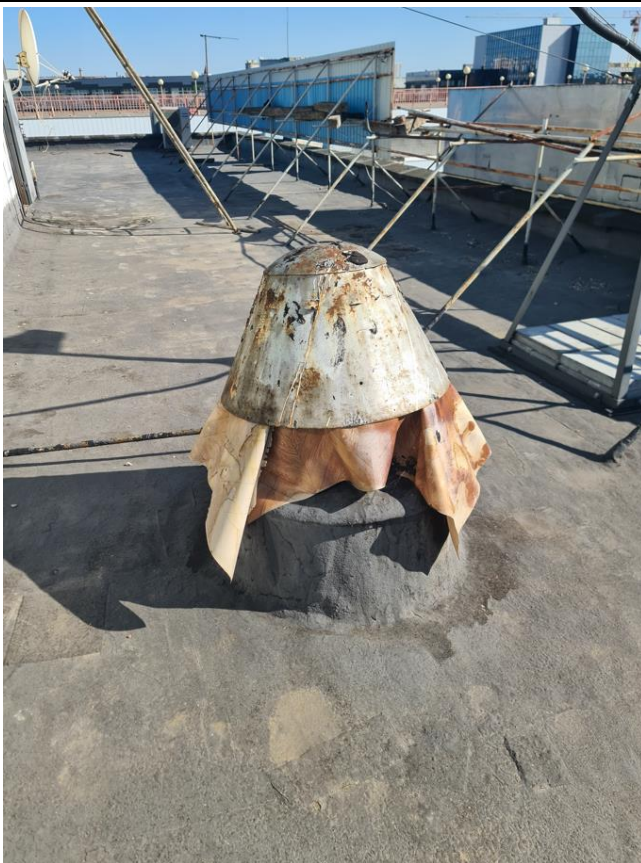
Фото 53. Нарушение работоспособности вентиляционной шахты. Коррозия металлического колпака вытяжной вентиляции
