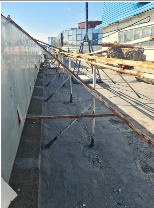
Фото 65. Коррозия металлического каркаса ограждающе-декоративных конструкций
