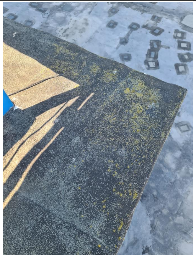
Фото 77. Замшелости кровельного покрытия
