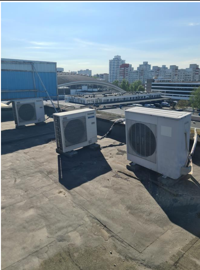
Фото 73. Общий вид оборудования на поверхности кровли в осях А/1
