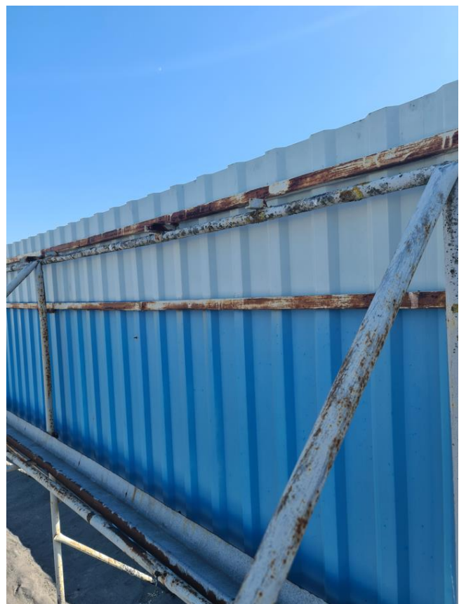
Фото 68. Разрушение окрасочного слоя, коррозия металлического каркаса ограждающе-декоративных конструкций
