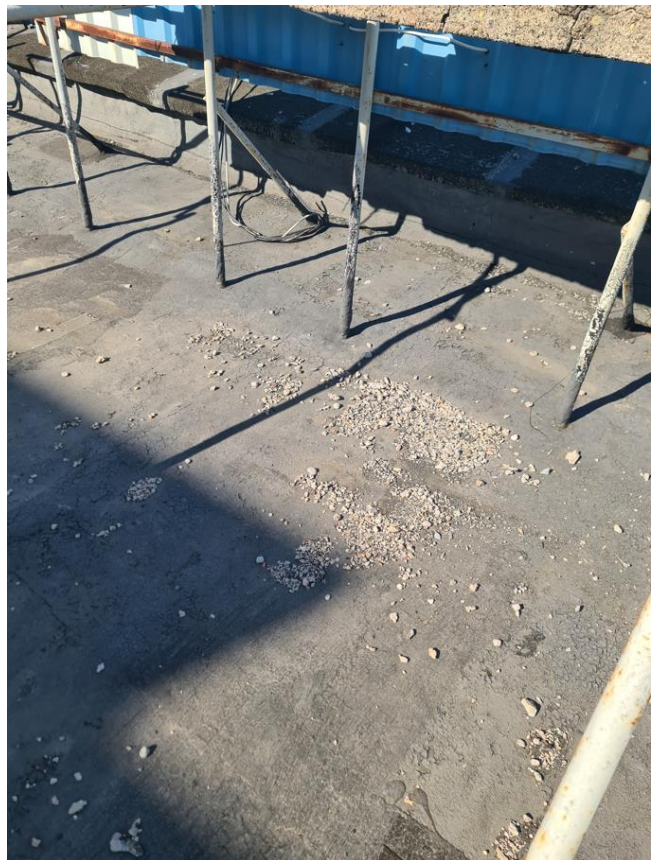
Фото 36. Износ, растрескивание кровельного покрытия
