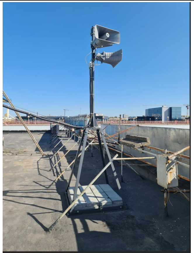
Фото 70. Общий вид системы оповещения населения
